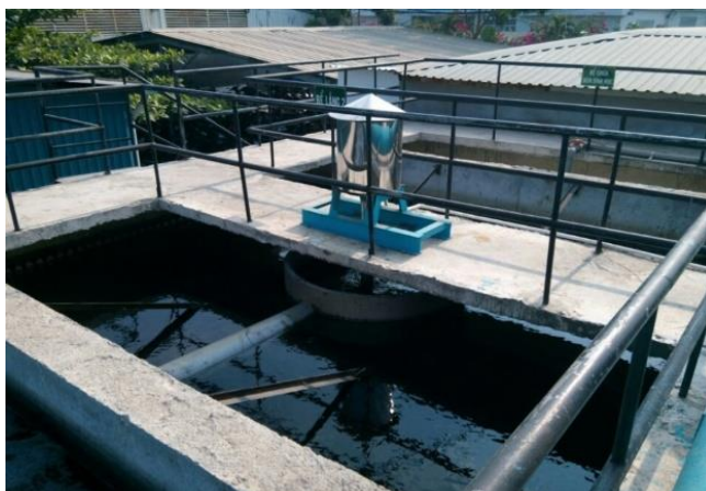
Hình 3.12. Bể lắng sinh học
