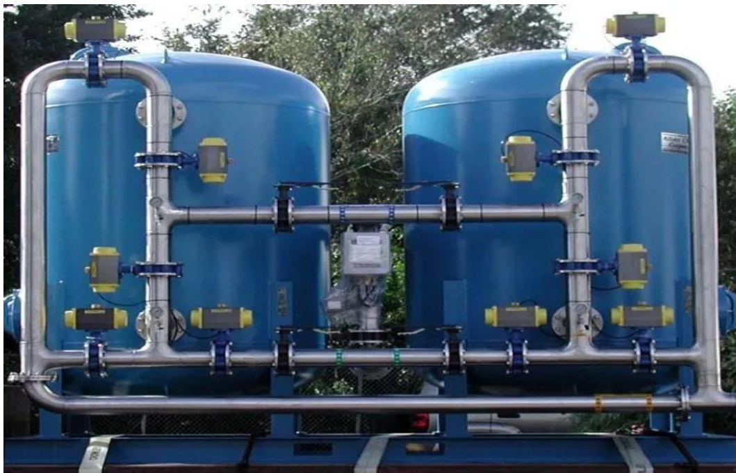
Hình 3.13. Hệ thống lọc áp lực
